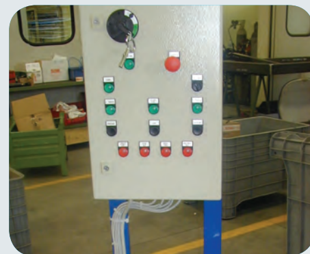
Centrale manovra valvole di sicurezza a farfalla in condotta.
